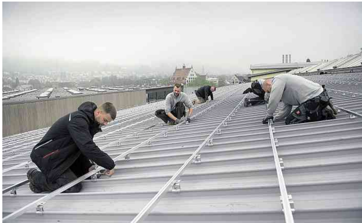
Schraube um Schraube: Auf den Dächern der Olma-Hallen 2 und 3 bauen Fachleute und Genossenschafter eine Solaranlage.
